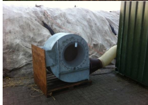
Figuur 1. Bewaarhoop te Langeweg in 2015. Via een ondergronds ventilatiekanaal werd bij voldoende koude buitenlucht mechanisch geventileerd.
